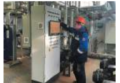
Установленное на Некрасовской котельной оборудование зарекомендовало себя с наилучшей стороны: надежное, эффективное и экономичное. Фото Семена Симоненко
