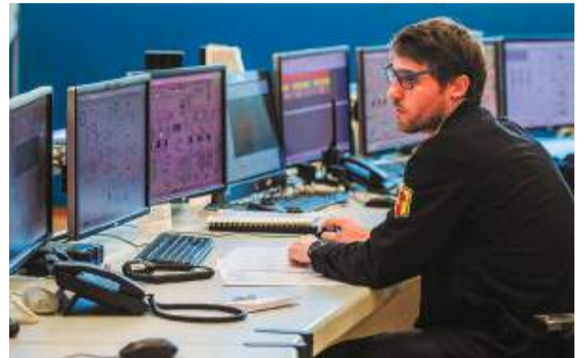
© Сердце станции — блочный щит управления. Фото Марии Каюровой
