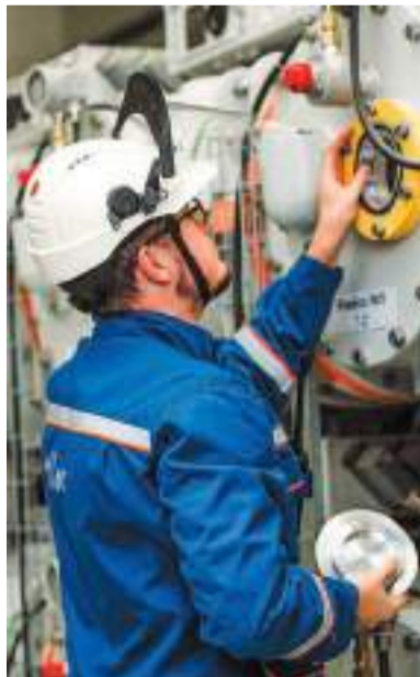
© Осмотр контактной системы шинного разъединителя комплекта распределительного устройства элегазового. Фото Марии Каюровой
