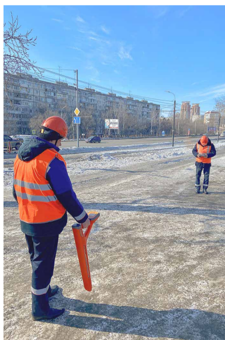
© Определение направления пролегания подземных участков теплотрассы и диагностика целостности трубопроводов. Фото: ХТС
